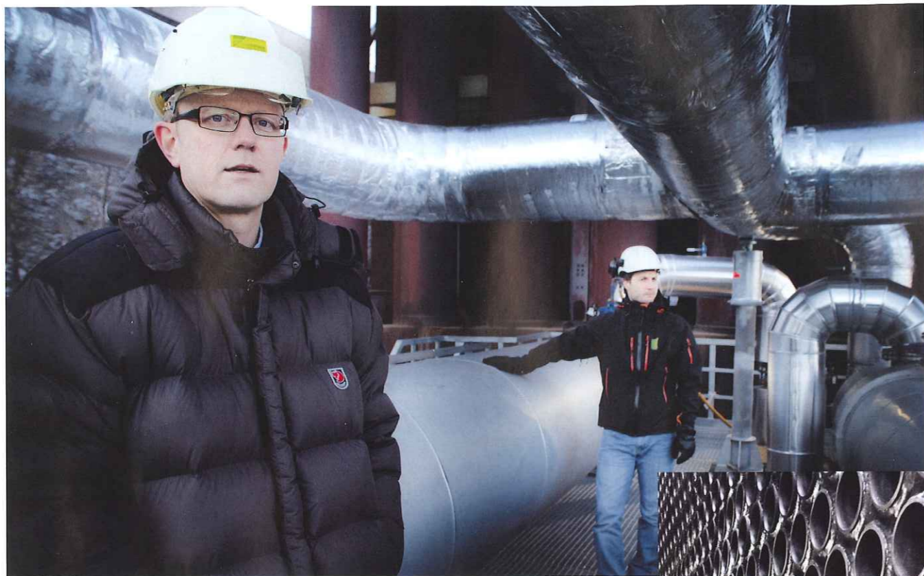
Daglig leder Terje Sund-Olsen (t.v.) og driftstekniker Ronny T. Straum i Mo Fjernvarme AS. Her inspiserer de det ferdige gjenvinningsanlegget ved Fesil Rana Metall, etter monteringen av den nye røygasskjelen, høsten 2011. Foto: MIP-Info.
