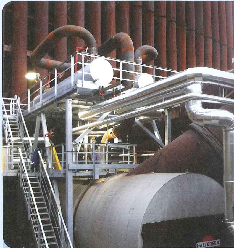
Den nye avgasskjelen til Mo Fjernvarme er bygd ved siden av eksisterende kjelanlegg. Anlegget utnytter røykgassen fra Fesil Rana Metall.
